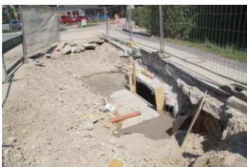
Hier wurden die Leitungen für das Regenüberlaufbecken wieder an das städtische Netz angeschlossen.
