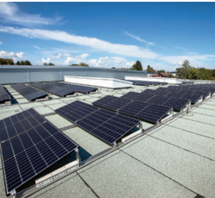
Ab 2023 setzt die Stadt Freilassing auf Öko-Strom mit Neuanlagenquote. Das Bild zeigt die Photovoltaikanlage auf der Sporthalle des Badylon. Foto: Egon Tempelin/Stadt Freilassing
